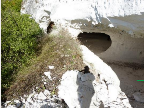
Corniches avant la purge
